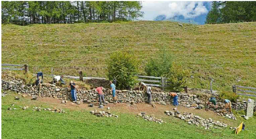
Vom 11. bis 23. September stehen Freiwillige beim Sanieren einer zerfallenden Trockenmauer in Donat im Einsatz.
