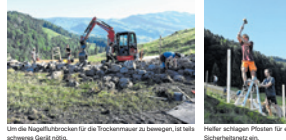
Im die Nagelfluhbrücken für die Trockenmauer zu beseitigen, ist es sehr schwierig, da es sehr steil ist.
