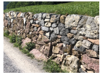
Neu sanierte Trockenmauer. Steine für Öffnungen für Bienen und Pflanzen bilden: sus
