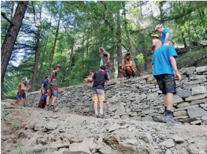
Insgesamt haben unter der Leitung der Stiftung Umwelteinsatz 33 Zivildienstleistende während zweier Jahre bei der Sanierung der einsturzgefährdeten Trockenmauern in Randa mitgeholfen.
