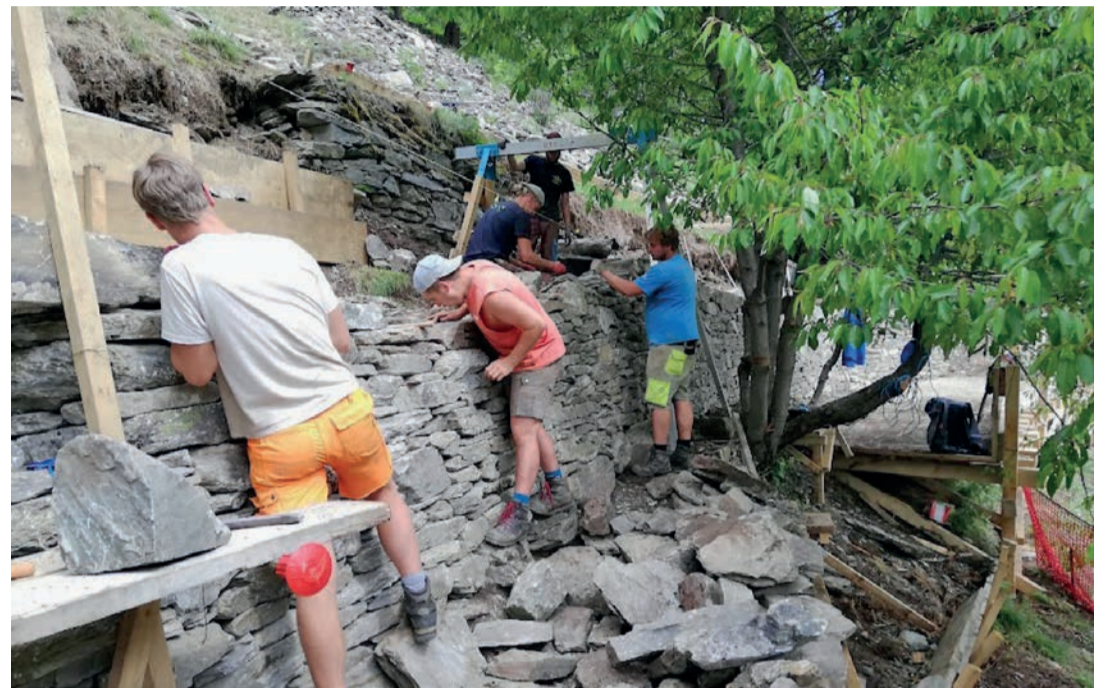
Unter der Leitung von Pascal Zobrist haben insgesamt 18 Zivildienstleistende vom 20. Juni bis 15. Juli 70 Quadratmeter stark beschädigte Trockenmauern in Randa saniert. Bilder: zvg
