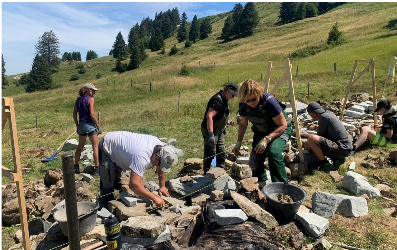
Freiwillige und Zivildienstleistende beim Trockenmauerbau im Appenzeller Bezirk Schwende-Rüte. (Bild: Stiftung Umwelteinsatz)
