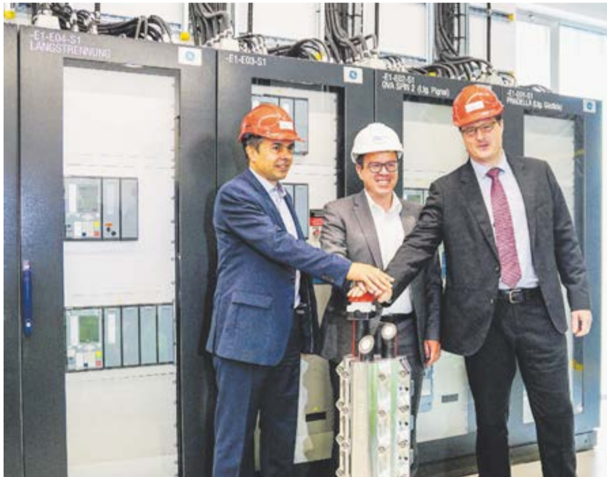
Gemeinsam haben sie in Zernez die Schaltzentrale in Betrieb gesetzt: Samuel Ansoorge, CEO der Brugg Kabel AG, Michael Roth, EKW-Direktor, und Christoph Rahm, Geschäftsführer der GE Grid GmbH (v.l.) Foto: Jon Duschletta
