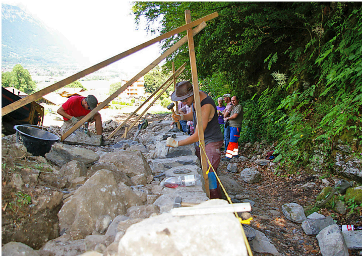
Die Arbeit der Zivildienstleistenden an der letzten Etappe der Trockenmauersanierung wurde von den anwesenden Besuchern mit Interesse verfolgt.
