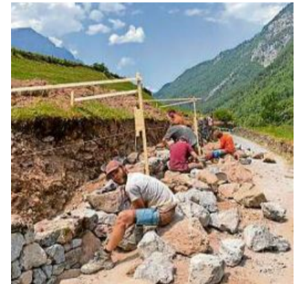
Stark beschädigt: Zivildienstleistende sanieren eine Trockenmauer entlang des Fusswegs ins Uschenriet. Pressebild
