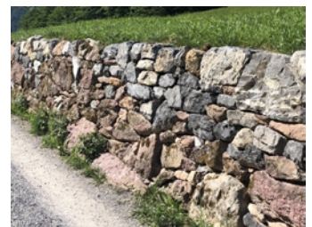
Neu sanierte Trockenmauer. Steine lagern auf Öffnungen für Bäume und Pflanzen (Bild: 202)
