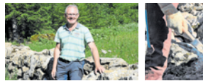
Rechts: Thomas Koller, Leiter der Sanierung der Trockenmauern im Gebiet Rütz im Jental.
