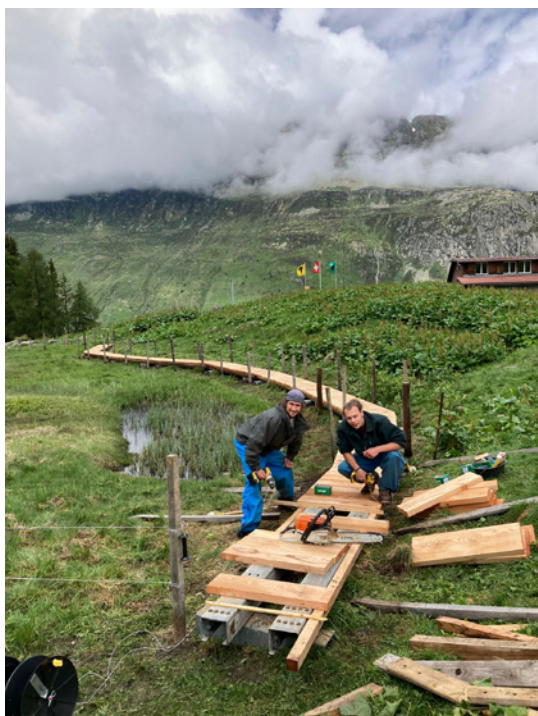
Construction d'un chemin en bois dans une zone à amphibiens sur le Göscheneralp.
