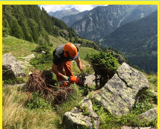
Travaux de débroussaillage sur la PPS Boliv au-dessus de Landarenca dans la vallée de Calanca.
